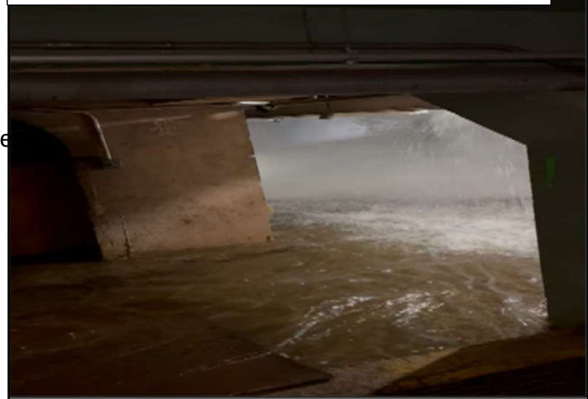
7 de agosto de 2023, falla de la válvula catastrófica PS principal
